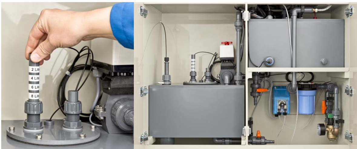
Abbildung 4: Füllstandsmesser des Dosierbehälters zur Überwachung der Restmenge an Chlordioxidlösung im Behälter (links). Ansicht des unteren
