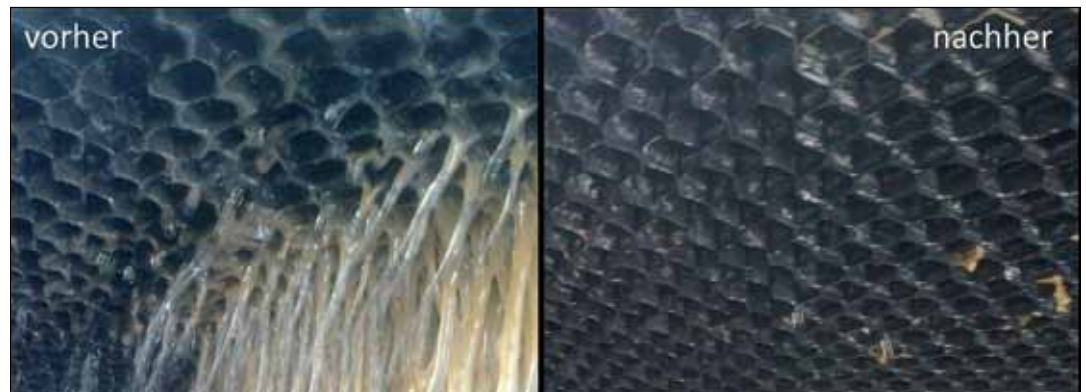
Abb. 1: vorher Bild: Schleimbildner im Kühlturm des Pasteurs (links); nachher Bild: Kühlturm des Pasteurs mit DK-DOX® Chlordioxid betrieben (rechts).
